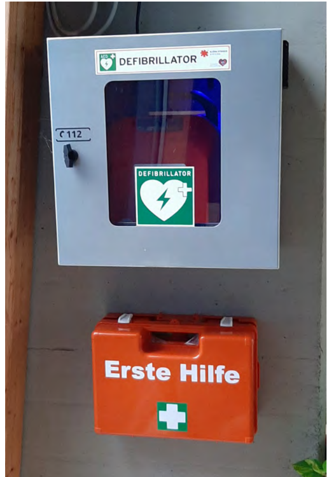
Der neue Defibrillator im Eingangsbereich der Landesschule Lünen steht im Notfall allen Anwesenden zur Verfügung. Er wurde mit Unterstützung der Björn Steiger Stiftung bereitgestellt.
